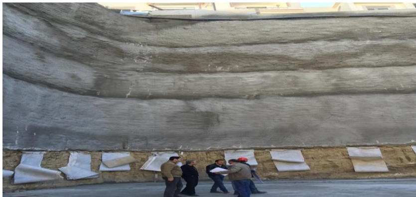
Figure 7. Vue de la paroi clouée à la fin de l'excavation de profondeur 20
